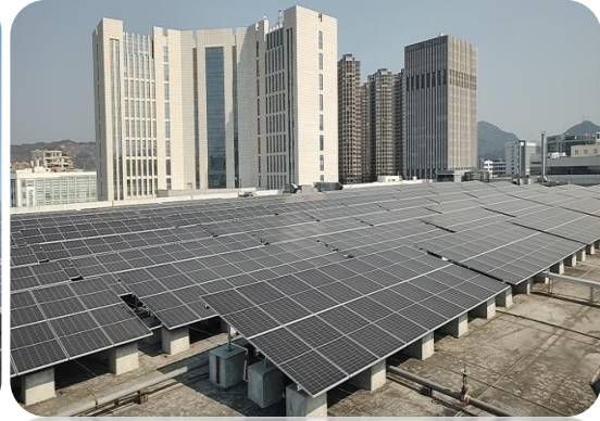
深科技东莞公司光伏发电
