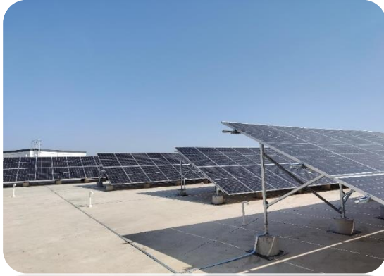
合肥沛顿存储公司光伏发电
